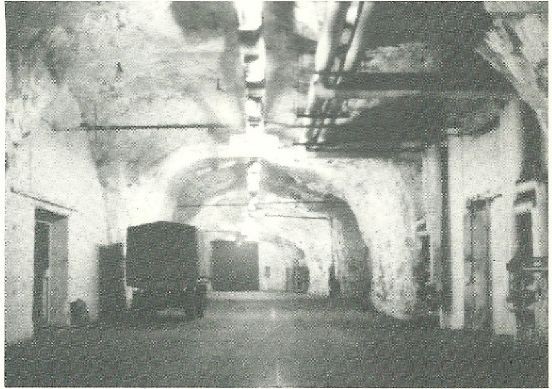
Le Tunnel - on remarque les installations pour les chambres frigorifiques, installées dans les galeries latérales.
